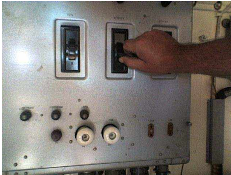
Рис.3.24 (а). Вимкнення автомату «АГРЕГАТ 1» на блоці № 44
