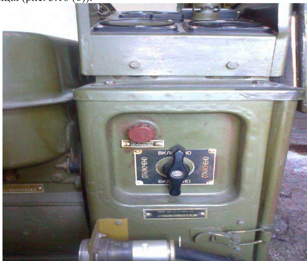
Рис. 3.16 (б). Запуск агрегату живлення
