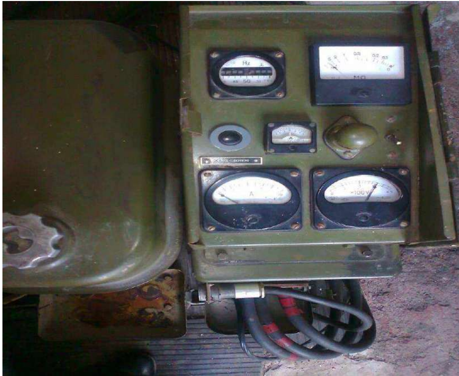
Рис. 3.16 (б) Контроль параметрів агрегату живлення
