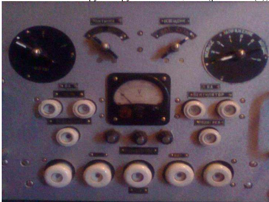
Рис. 3.16 (в). Вмикання радіостанції на блоці автотрансформатора
