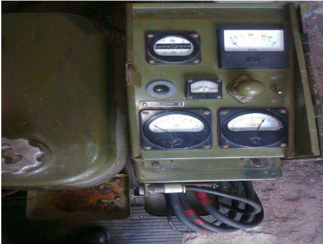
Рис. 3.13 (б). Контроль роботи агрегату живлення Вмикається радіопеленгатор, перемикається на пульті керування в місцевий режим роботи
