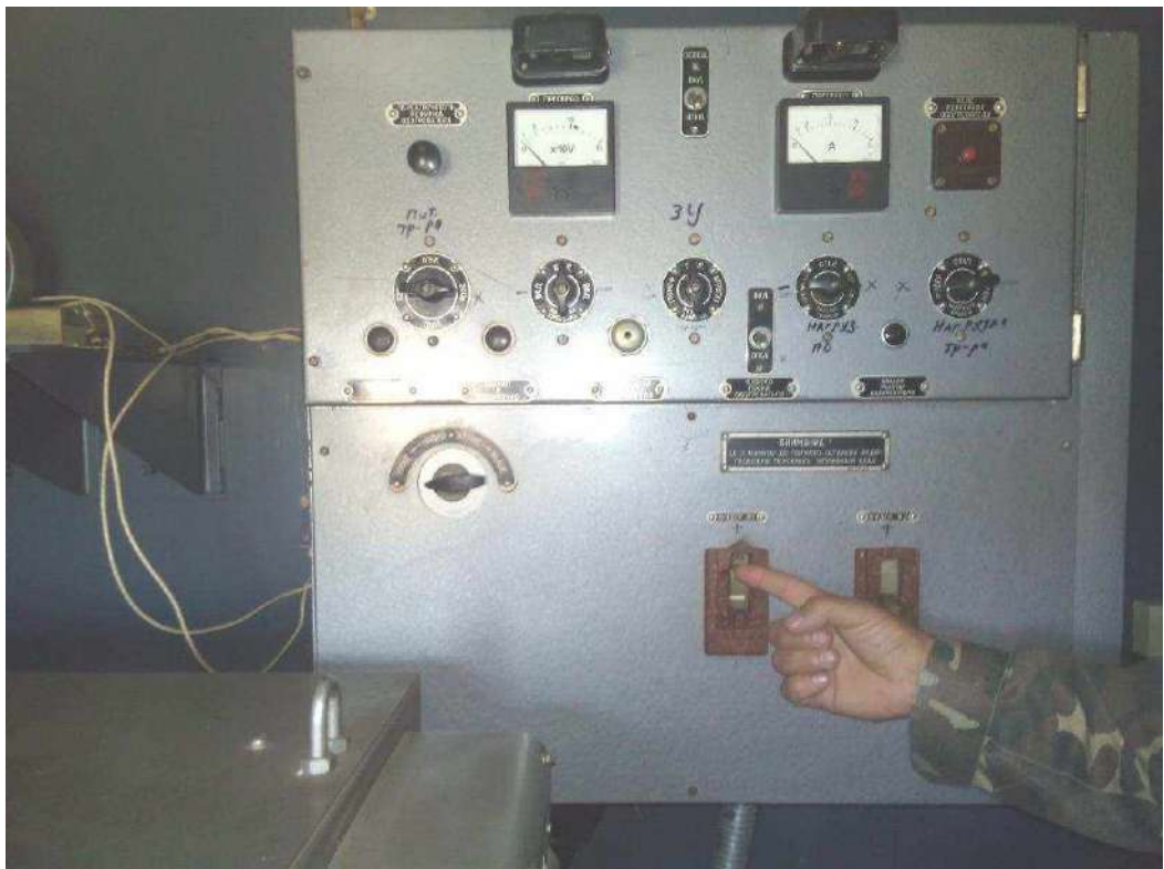
Рис. 3.21 (б). Подача напруги на апаратну РСР-6М2 через щит живлення
