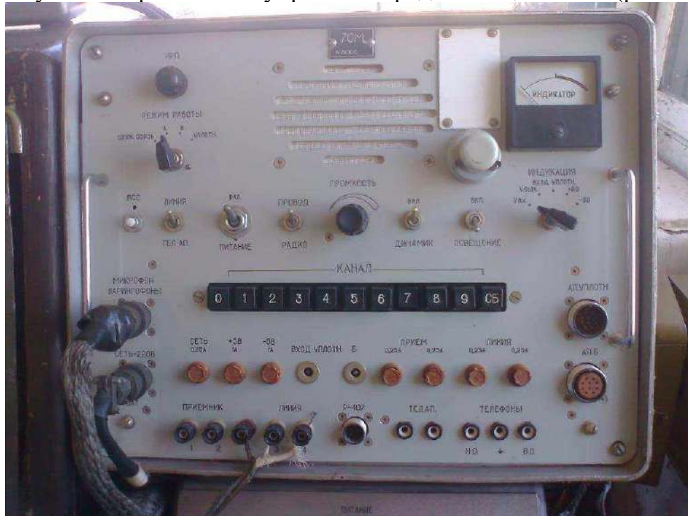
Рис. 3.10 (д). Зовнішній вид ВПУ блок 70М
