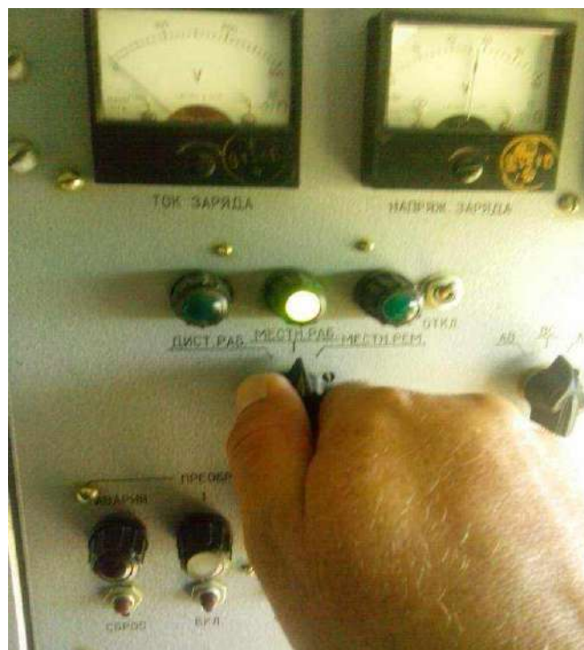
Рис. 3.20 (в). Щит живлення
