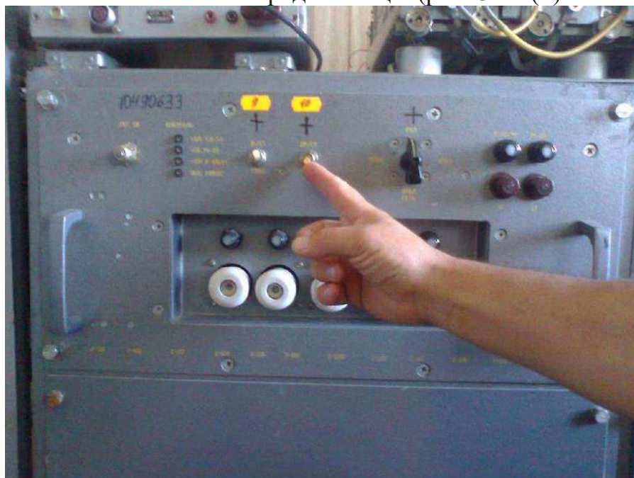
Рис. 3.11 (б). Вмикання радіостанції на стійці живлення та управління
