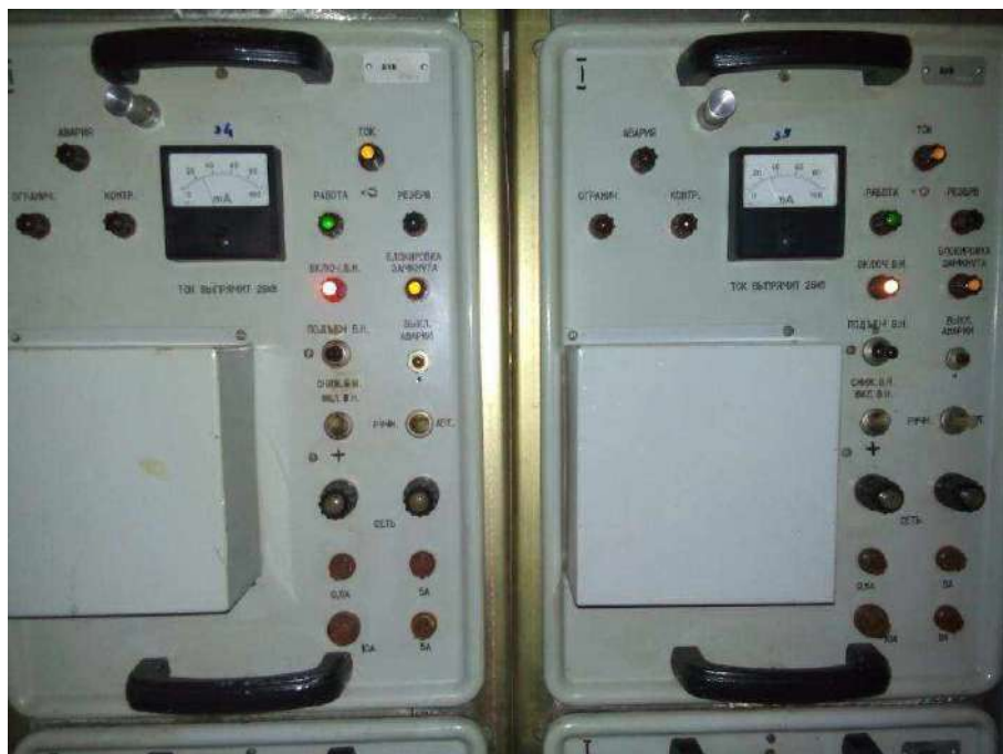
Рис. 3.21 (в). Перевірка вмикання передавачів ДРЛ
