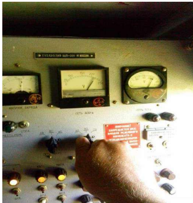
Рис. 3.20 (б). Перевірка напруги живлення по вмонтованим приладам
