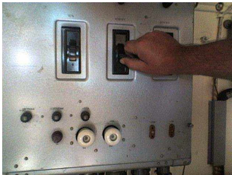
Рис.3.25 (б). Ввімкнення автомату «АГРЕГАТ 1» на блоці № 44
