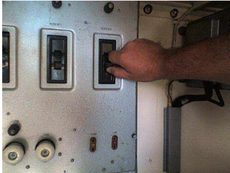
Рис.3.25 (б). Ввімкнення автомату «АГРЕГАТ 2» на блоці № 44
