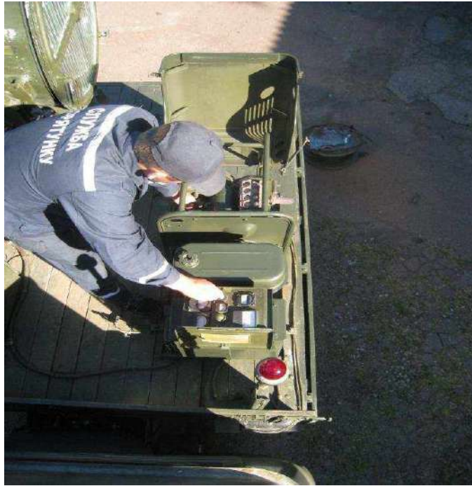
Рис. 3.22 (б). Встановлення напруги 220 В і частоти 50 Гц за допомогою щитового приладу
