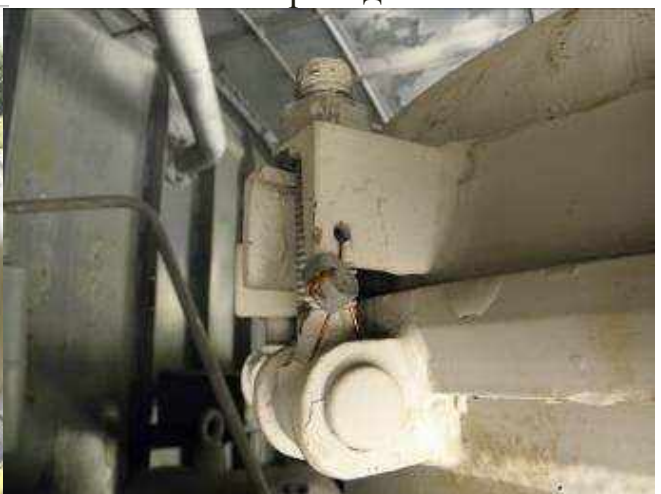
Рис.1.2 (г). Перевірка пломбування вузлів і агрегатів установки
