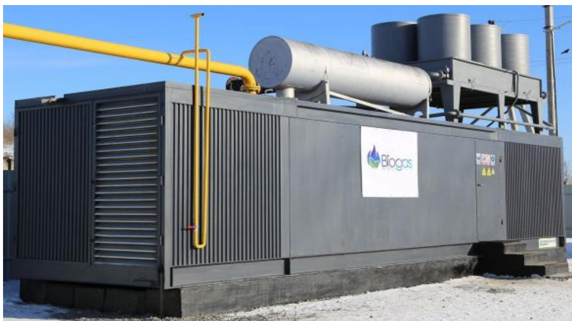
Рисунок 3.1. Когенераційна установка в контейнерному виконанні
