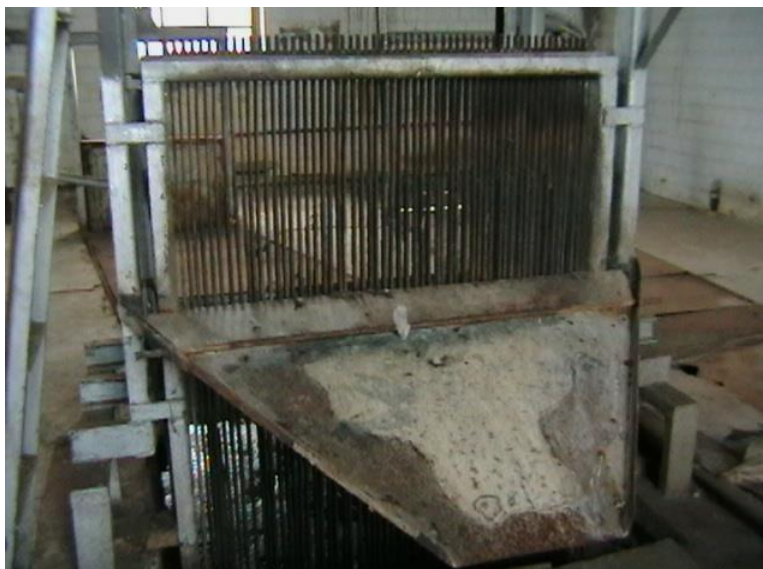
Рисунок 3.1 – Очисні споруди м. Херсона (решітки).
